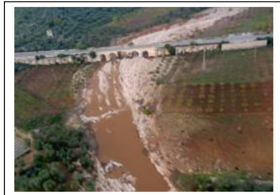
Figura 6 – Ramo del Torrente Picone interessato dalla piena del 23 ottobre 2005.
